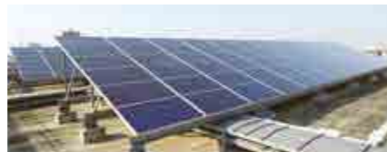
太陽光発電設備を全機関に設置
