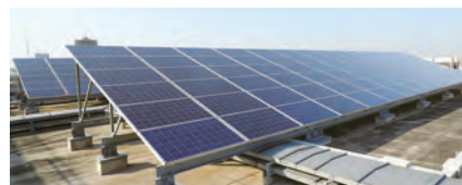
太陽光発電設備
