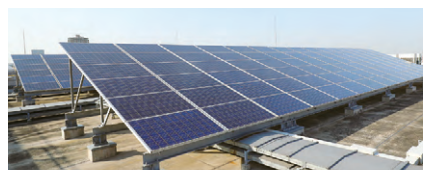
太陽光発電設備
