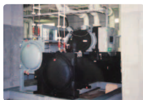
ターボ冷凍機
