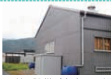
再利用設備(倉庫の雨樋を雨水タンクに接続)
